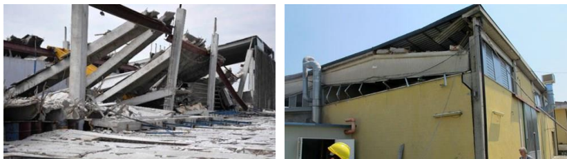
Figura 12. Evidenza dei cinematismi di collasso nei fabbricati industriali
