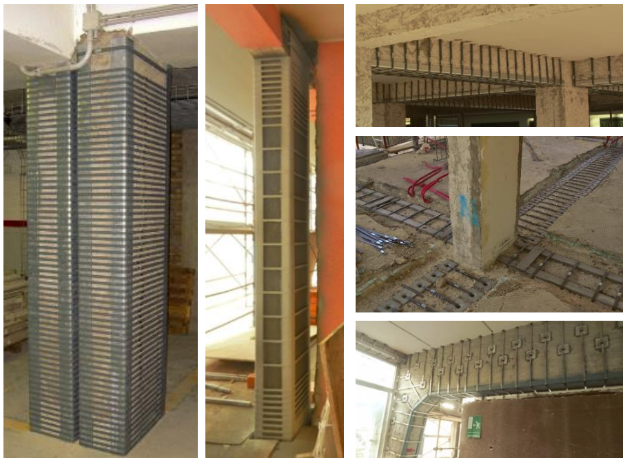
Figure 16. Interventi CAM ® mirati allo scongiurare meccanismi fragili per schiacciamento e taglio su pilastri e travi in CA
